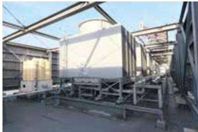
空調機器 (冷却塔)
