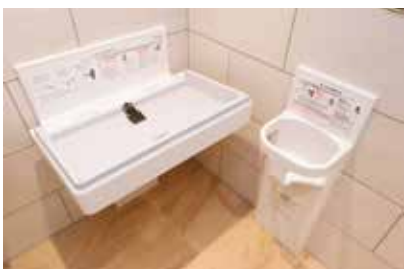
ベビーベッド・ベビーチェア(トイレ内)
