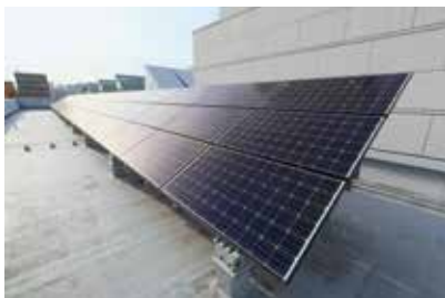
太陽光パネル
